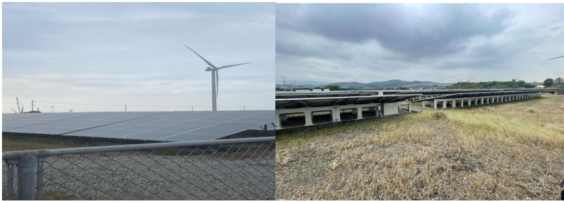
【北九州市 市民太陽光発電所内】
