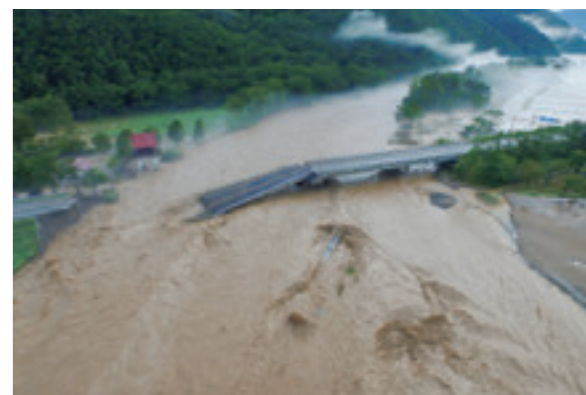
ドローンで撮影した千呂露橋の被災状況（北海道開発局提供）
